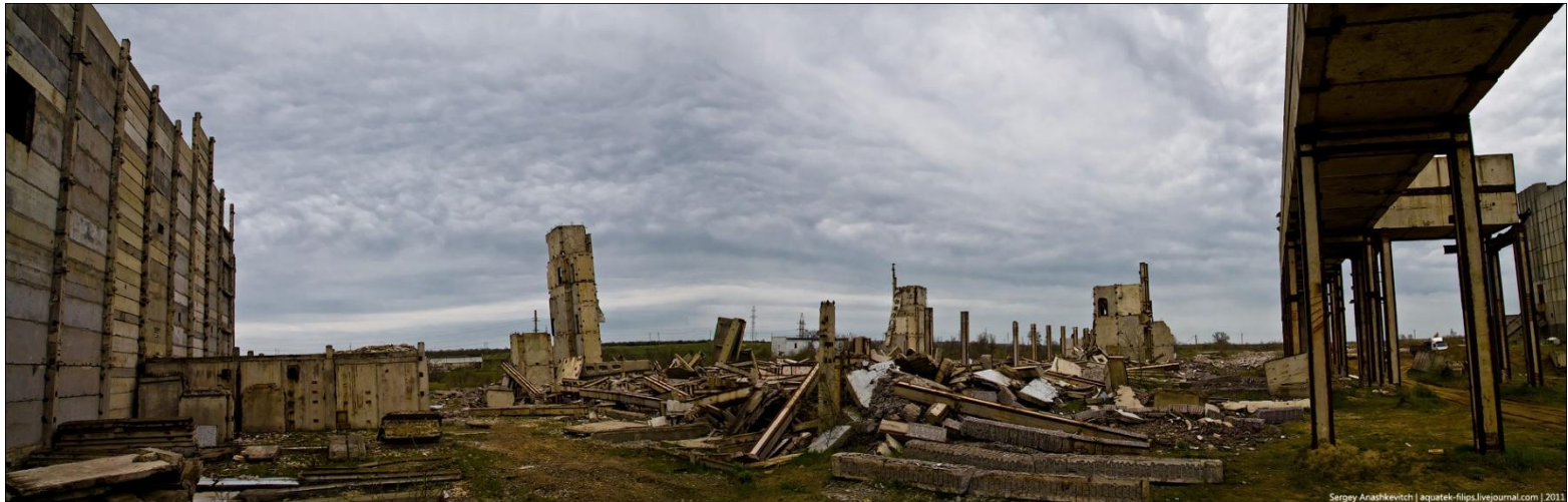
Obr. 30: Hroucí se budovy nedostavěné elektrárny [20].
